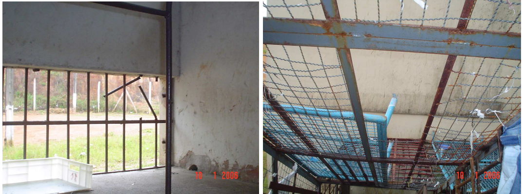
(Foto 01: grade do pátio do banho de sol já serradas; Foto 02: grades do teto do acesso externo totalmente quebradas)
