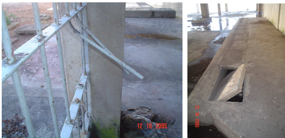
(Foto 01: grades cerradas no pátio de visitas; Foto 02: tampa de concreto facilmente aberta no pátio)
