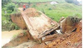
MORADOR se arrisca para passar em ponte destruída em Laranjá da Terra
